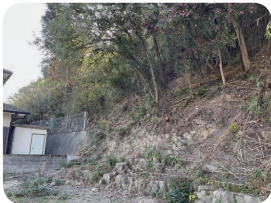
八日山地区の危険な急傾斜地
