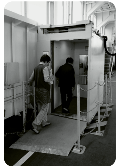
フェリーのエレベーター
