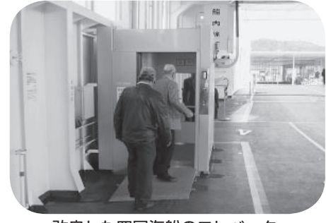
改良した四国汽船のエレベーター
